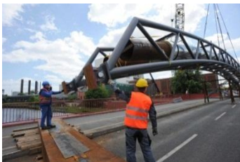
Kürzlich neu erreichtet: eine Rohrbrücke am HKW Moabit
